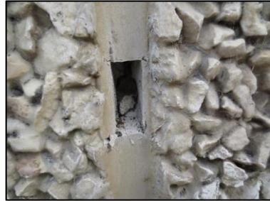
Photo N° 3213 ECH-N°29 - BAT113-157 pignons Murs Joint de dilatation
