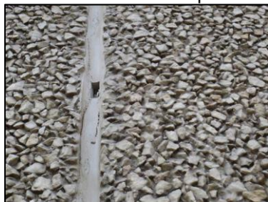
Photo N° 3204 ECH-N°23 -BAT 177-277 pignons Murs Joint de dilatation
