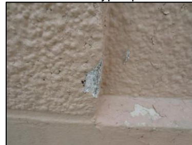
Photo N° 3182 ECH-N°09 -BAT 86-190 pignons Murs local béton+crepi+peinture
