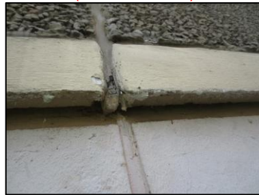
Photo N° 3239 ECH-N°50 - BAT113-157 pignons Murs Joint de dilatation
