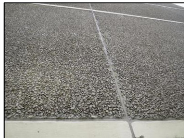
Photo N° 3242 ECH-N°53 - BAT113-157 pignons Murs béton+pierres
