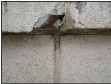
Photo N° 3191 ECH-N°14 -BAT 32-210 pignons Murs béton+pierres
