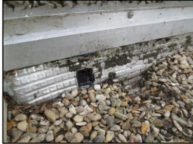
Photo N° 3171 ECH-N°01 -BAT 86-190 pignons Murs Etanchéité type "paxalu"
