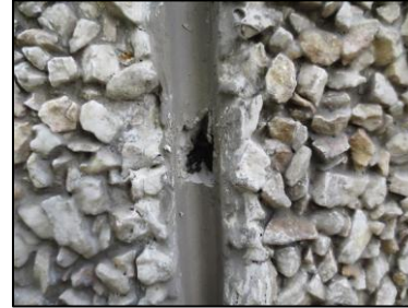
Photo N° 3173 ECH-N°03 -BAT 86-190 pignons Murs Joint de dilatation
