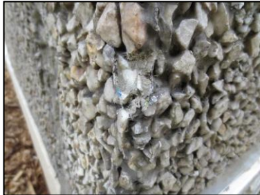
Photo N° 3174 ECH-N°04 -BAT 86-190 pignons Murs béton+pierres
