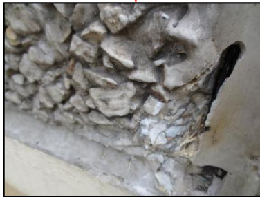
Photo N° 3195 ECH-N°17 -BAT 32-210 pignons Murs béton+pierres
