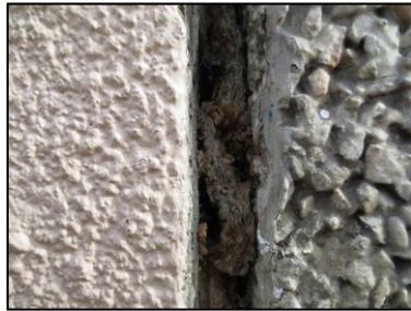
Photo N° 3186 ECH-N°11 -BAT 86-190 pignons Entre le mur du local et mur du bâtiment Joint fibreux
