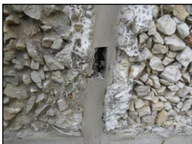
Photo N° 3199 ECH-N°19 --NC-BAT 177-277 pignons Murs Joint de dilatation
