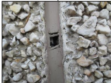
Photo N° 3179 ECH-N°07 -BAT 86-190 pignons Murs Joint de dilatation
