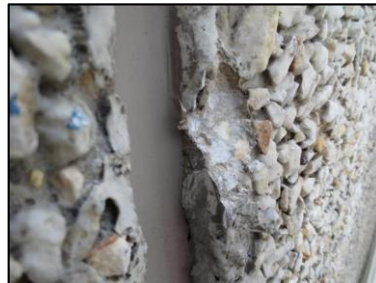
Photo N° 3180 ECH-N°08 -BAT 86-190 pignons Murs béton+pierres
